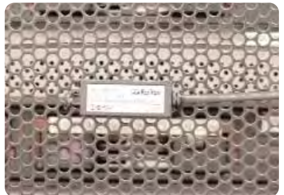
Beispiel eines am Einlass für kühle Luft am Serverschrank befestigten Temperatursensors. Der Sensor ist an einer intelligenten PDU (nicht angezeigt) angeschlossen.
